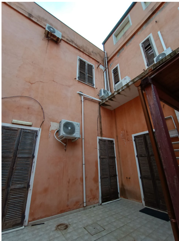
Immagine 18 – Intonaco esterno stato attuale
