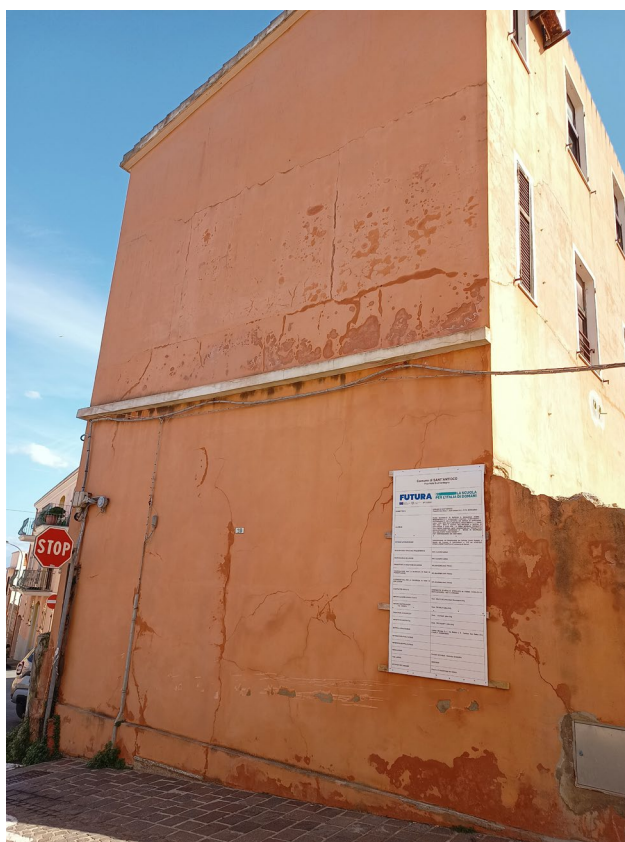
Immagine 17 – Intonaco esterno stato attuale
