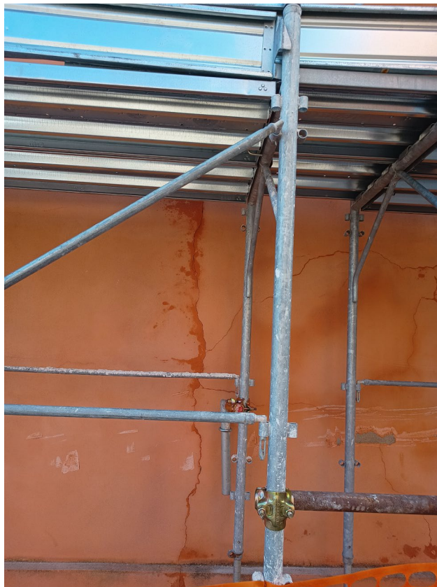
Immagine 16 – Intonaco esterno stato attuale
